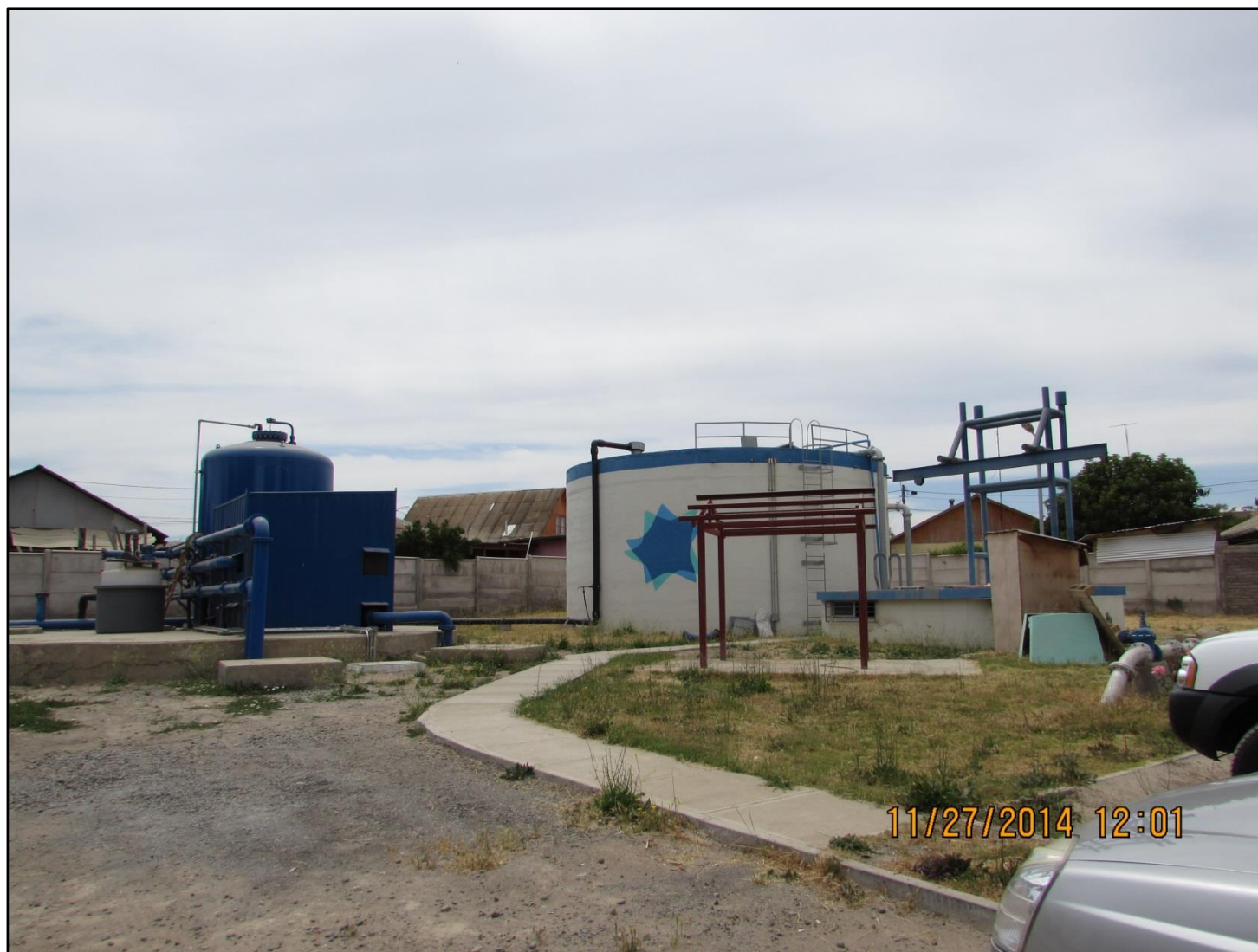
Figura 2. Recinto de Sondajes, Estanques y Planta de Tratamiento de Agua Potable de Peralillo
